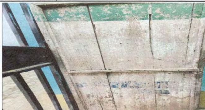
Foto 1: Sustrucción de puerta.
